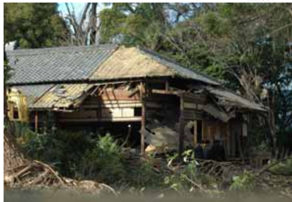
●破壊された主屋の東南部分の屋根
