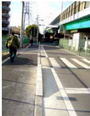
防音壁が劣化し頭 上に落下野崎外環 (破損箇所修繕)
